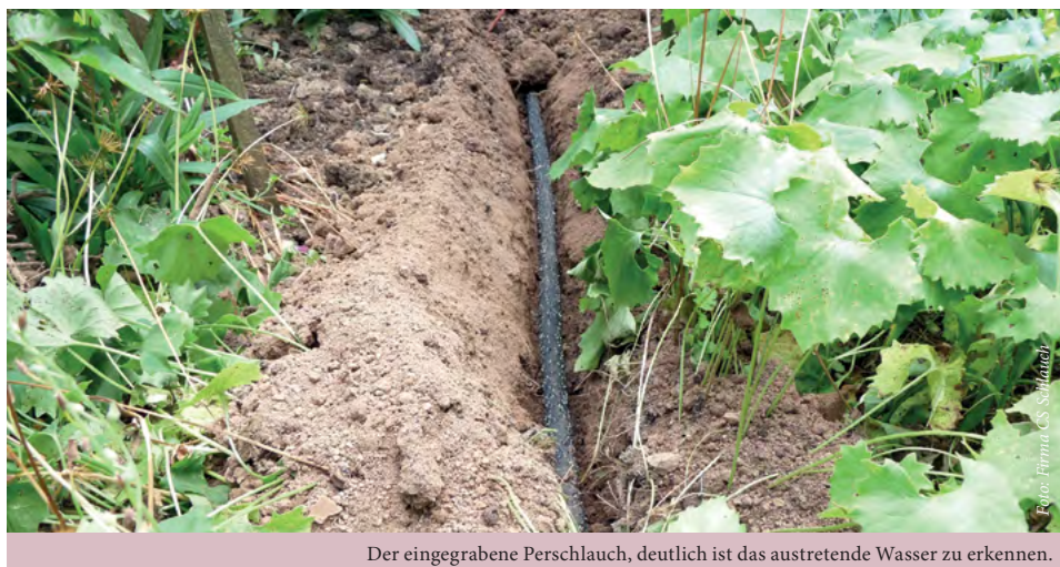
Der eingegrabene Perlschlauch, deutlich ist das austretende Wasser zu erkennen.
